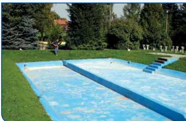
Altes Betonbecken im Freibad Dermbach, damalige Nutzung als Vorwärmbecken und Planschbecken
